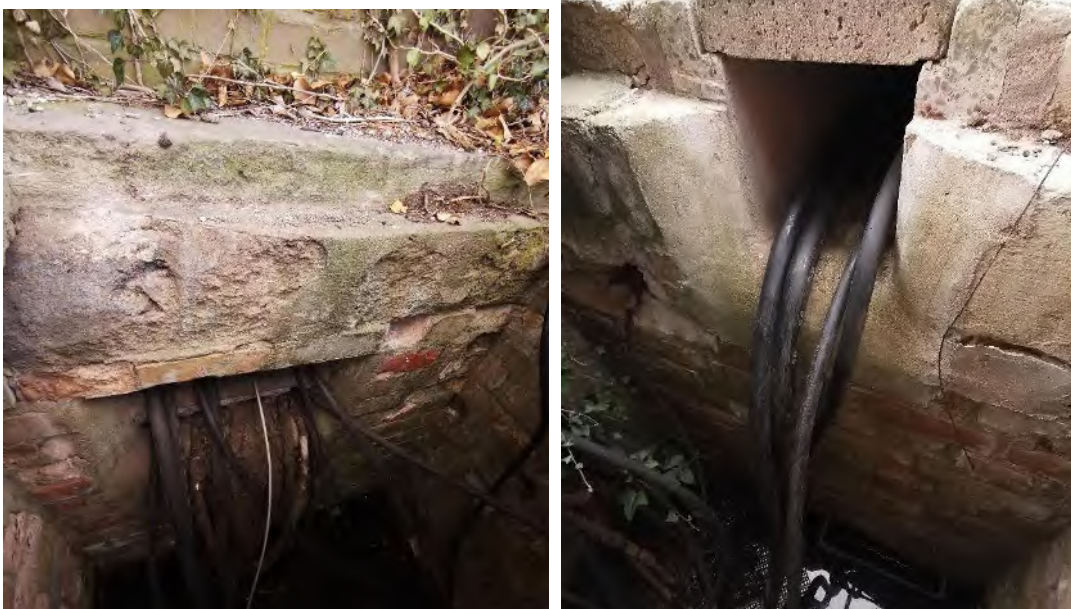
Abb. 18 / 19: Schacht am RS III Gebäudeeinführung – Blickrichtung Süden und Anschluss Kabelkanal – Blickrichtung Norden
