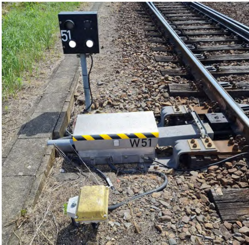
Abb. 2: Weichenantrieb und Weichensignal Weiche 51 – Blickrichtung Osten
